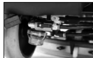
Fig. 8 Regulador de agua totalmente abierto
